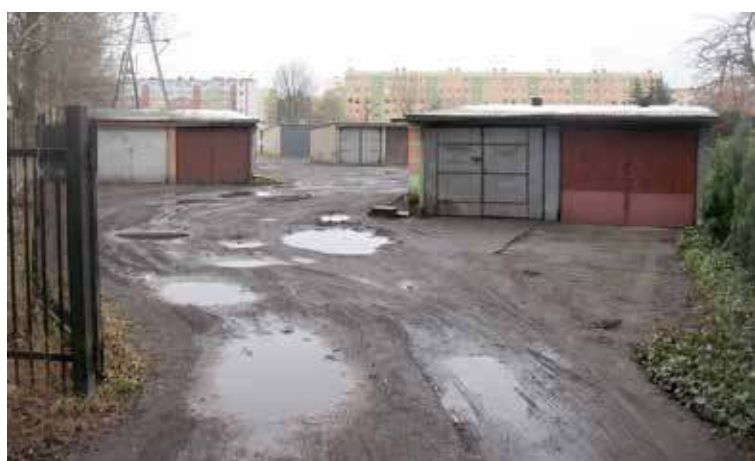
Zły stan nawierzchni jest widoczny już od samej bramy
