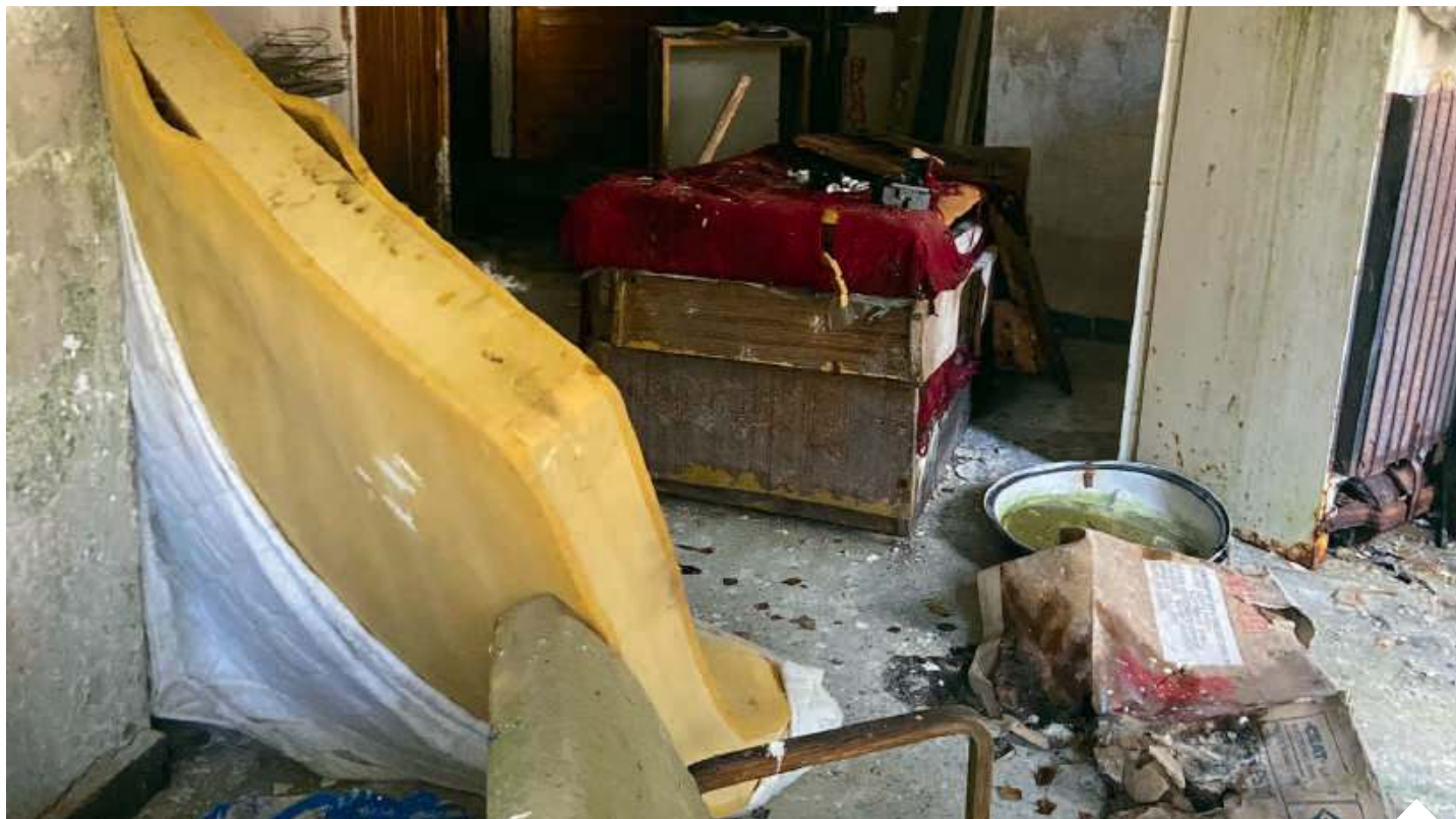
Budynki w ośrodku w Skubiance zostały całkowicie zdewastowane. Las, który otacza ośrodek, został pozostawiony sam sobie. Nieruchomości, które znalazły się na terenie, są w fatalnym stanie technicznym | fot. Twitter/@GzowskiMichal/d
