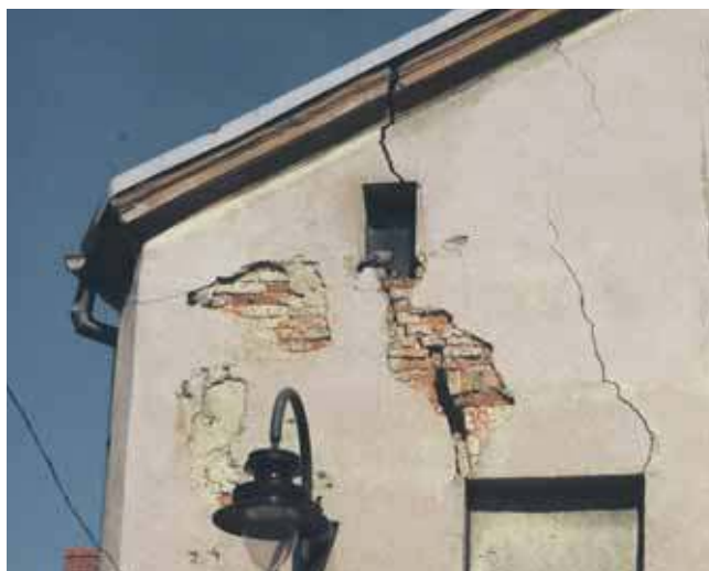
Gołym okiem widać, że pęknięcia nie są powierzchowne
