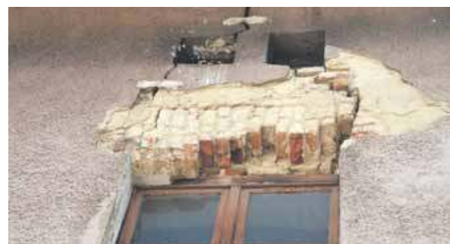
Trudno z poziomu chodnika dociec, na czym trzyma się ceglany łuk nad oknem na pierwszym piętrze
