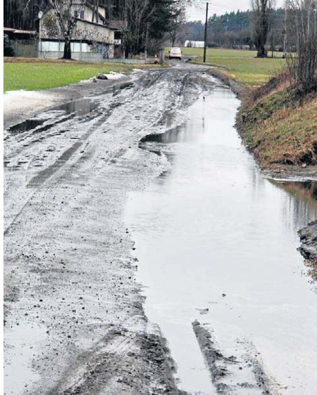
Błoto i głębokie koleiny skutecznie utrudniały przejazd ulicą Zachodnią
