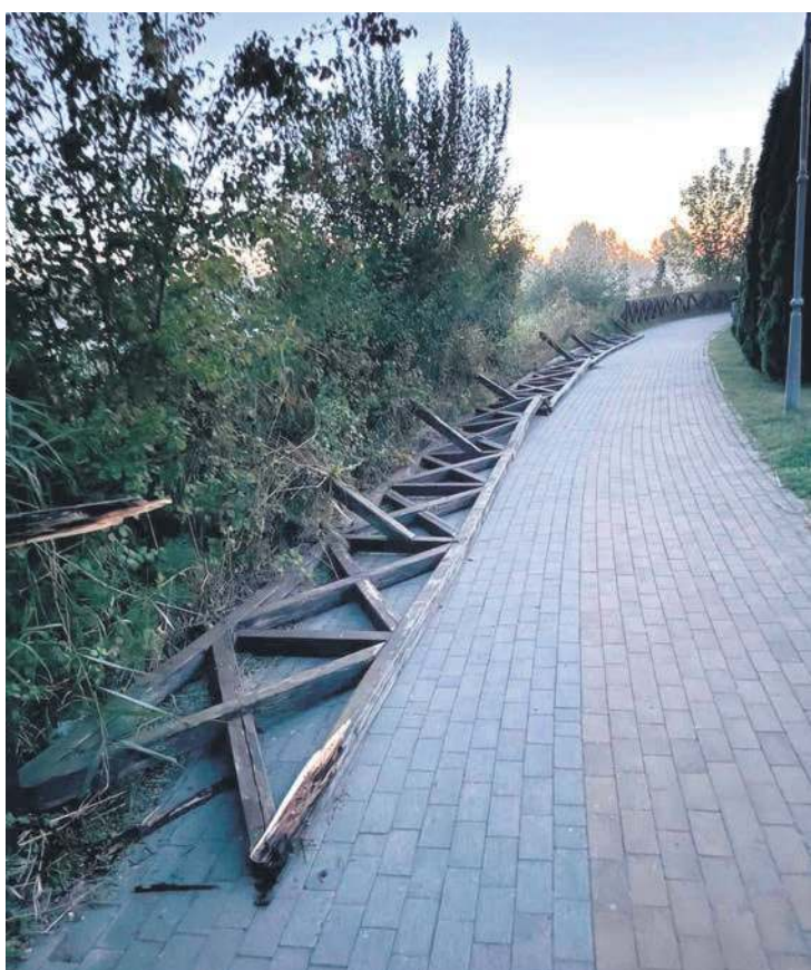
Zniszczone ogrodzenia na promenadzie. Około dwa miesiące temu także z tej strony jeziora ktoś połamał dużą drewnianą wiatę. Tucholski ratusz nie wyklucza, że w tym miejscu stanie nowe ogrodzenie. Fot. Gmina Tuchola
