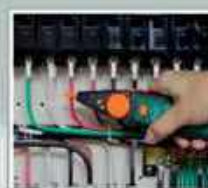
bezprzewodowa detekcja napięcia
