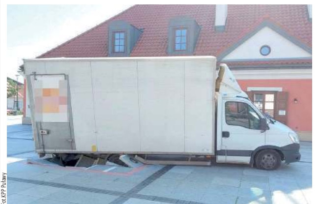
Pod ciężarem dostawczego samochodu płyty ustąpiły. Pod spodem była instalacja znajdująca się na rynku fontanny
