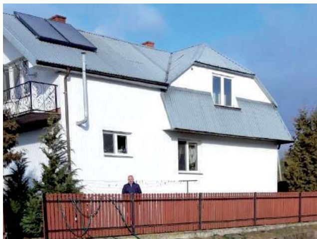
Z powodu braku w firmie odpowiedniego stelażu, solary u państwa Mazurów zostały zamontowane na dachu, zamiast na południowej ścianie domu. Właściciel teraz ocenia, że to był błąd
