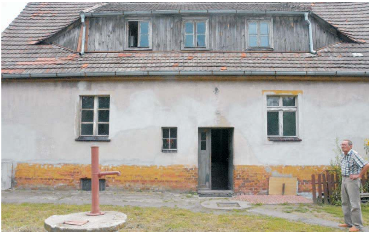
Mieczysław Banaś przed budynkiem komunalnym przy ul. Dzierżonia. Twierdzi, że jego rodzinę urzędnicy potraktowali niesprawiedliwie
