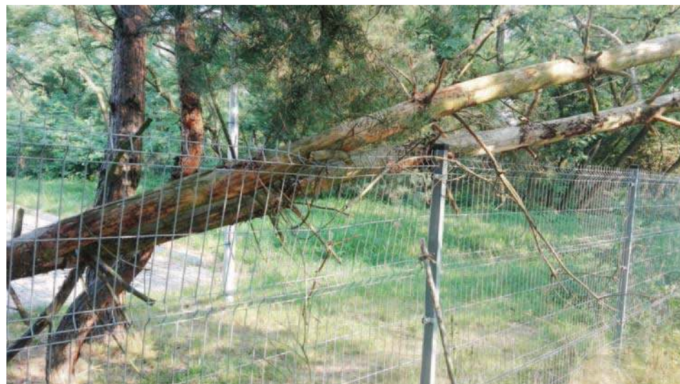
Tu drzewo wciąż jeszcze leży na płocie i uszkadza go
