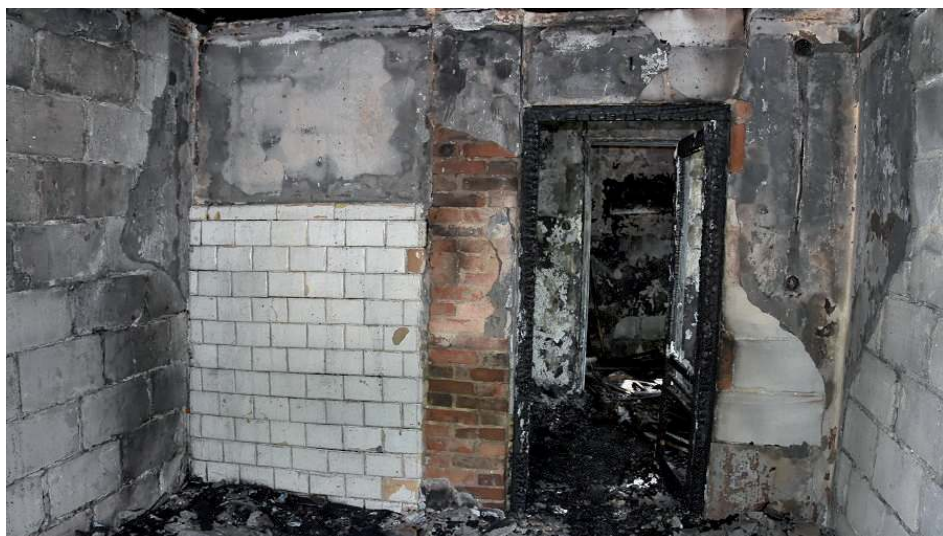
Skutki podpalenia niezamieszkałego domu
