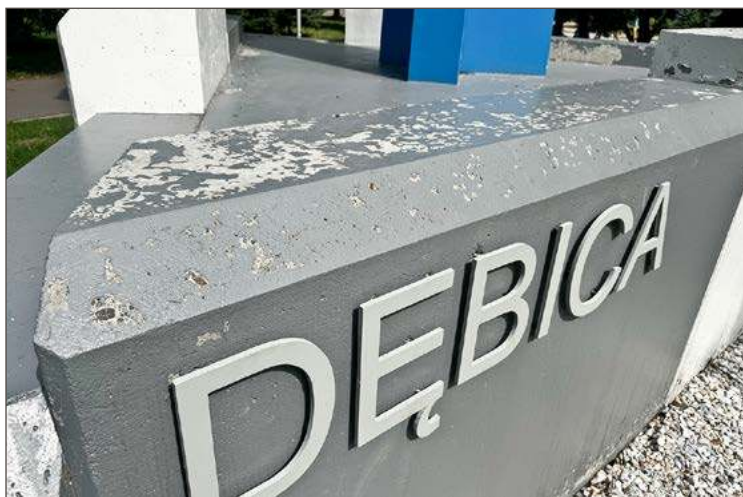
Z betonowego cokołu schodzi tak szara, jak i biała farba.
