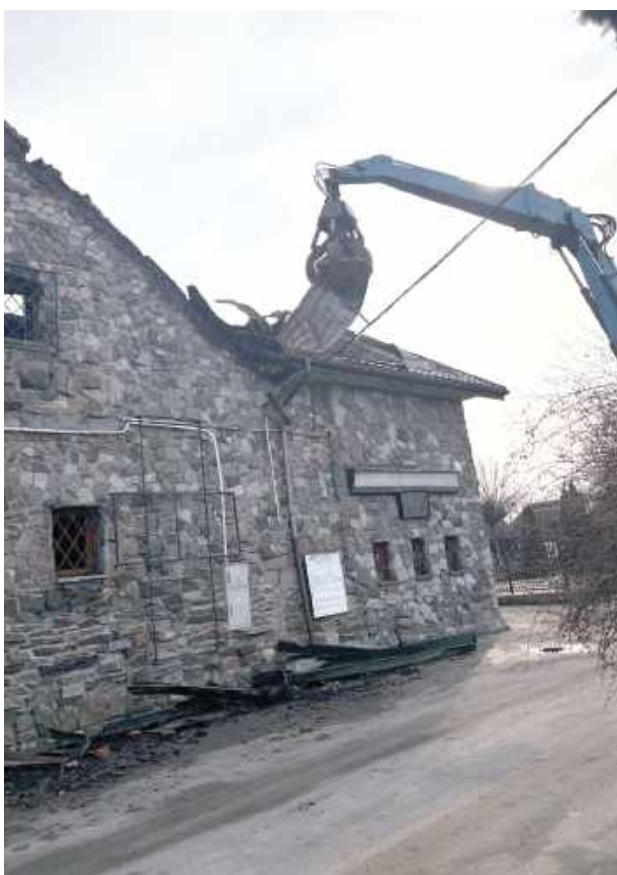
Właściciele lokalu poinformowali właśnie, że rozpoczęto prace porządkowe, których bezpłatnie podjęła się firma Stan-Mar Surowce Wtórne z Warszawy
