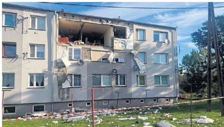
Straż pożarna musiała zabezpieczyć zerwane ściany plandekami
