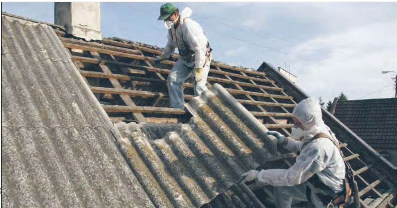
Eternit powinien całkowicie zniknąć z polskich dachów do 2032 roku. Jednak, patrząc na dotychczasowe tempo realizacji tego celu, osiągnięcie go wydaje się mało realne
