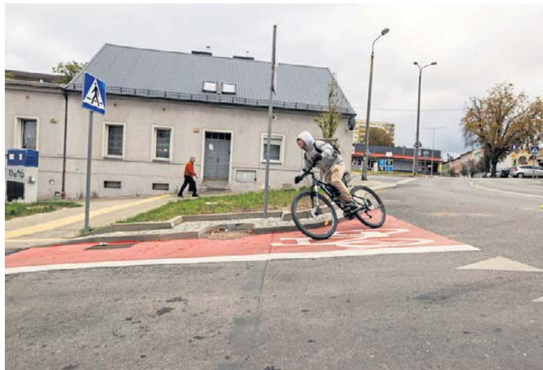
Duże uszkodzenia ulicy Podgórnej dobrze widoczne były na pasie rowerowym. Wszystko zostało już naprawione
