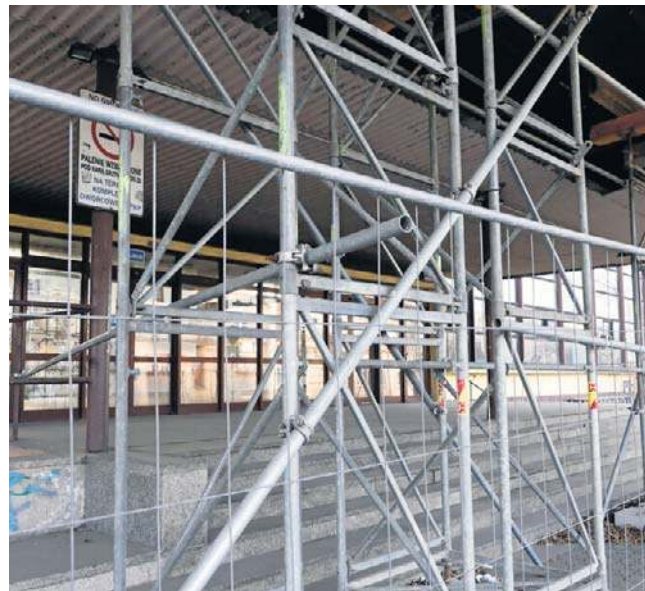
Dach nad głównym wejściem na dworzec PKP trzeba było podeprzeć, aby nie runął
