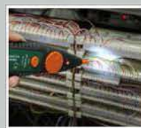
podświetlenie miejsca pracy
