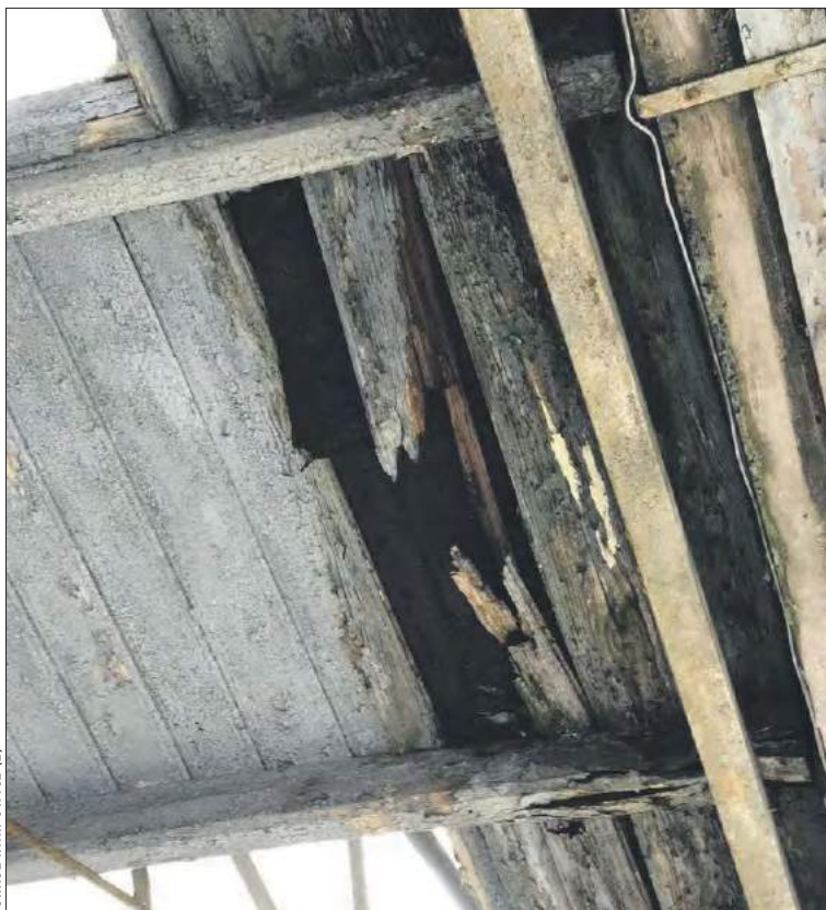
Czytelnik od roku nie może doprosić się remontu wiaty na dworcu kolejowym w Prudniku
