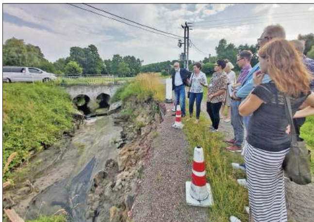
Podczas wizji lokalnej 9 lipca sprawdzono stan cieku Syrynka i uszkodzonego przepustu przy ul. Szybowej. Będzie on naprawiony, a potok w okolicy mostku zostanie wyczyszczony
