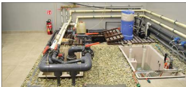
Stacje uzdatniania wody. Mimo zastosowania oddzielnych instalacji dla każdej z dwóch niecek, po uruchomieniu basenu okazało się, że dochodzi do wymieszania wody z obu niecek.
