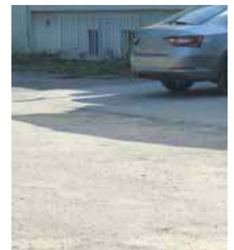
Szpital planuje nie tylko remont dziurawej drogi dojazdowej do przychodni, ale i schodów
