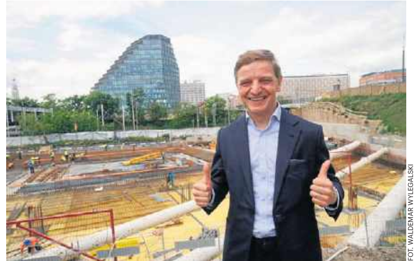
Dyrektor Teatru Muzycznego w Poznaniu przy terenie budowy nowej siedziby instytucji, która ma być oddana przed końcem 2028 roku
