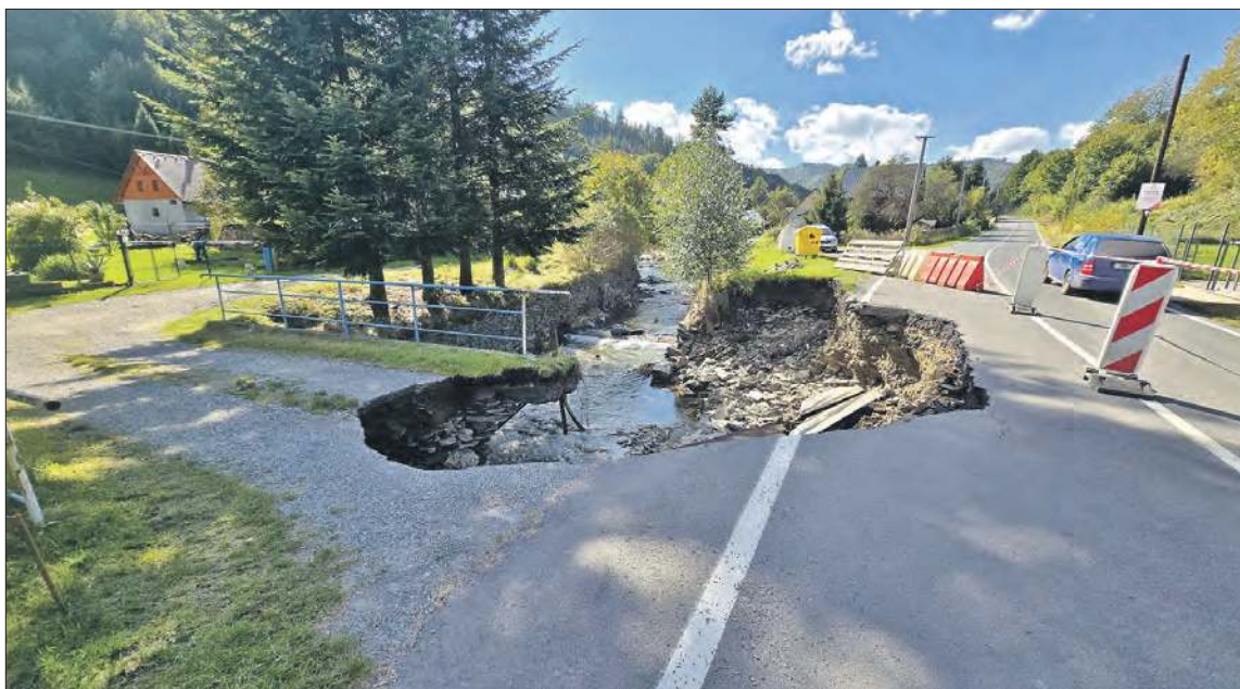
Ogromna wyrwa w drodze. Powstała, ponieważ prześwit w znajdującym się tu moście był niewystarczający i woda zaczęła drążyć nowe ujście.
