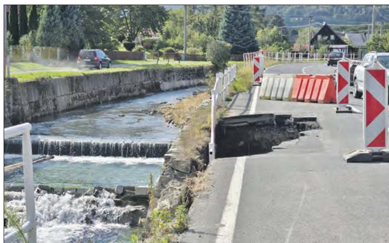
Na żadnym odcinku szosy jezdni nie została przerwana na całej szerokości.
