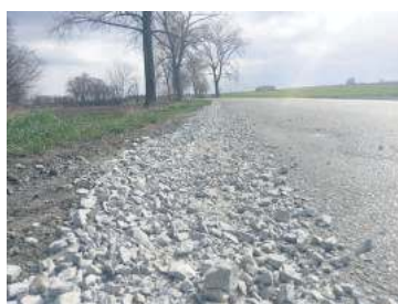
Główną przyczyną złego stanu drogi jest transport kruszywa ciężkimi pojazdami z pobliskiej kopalni
