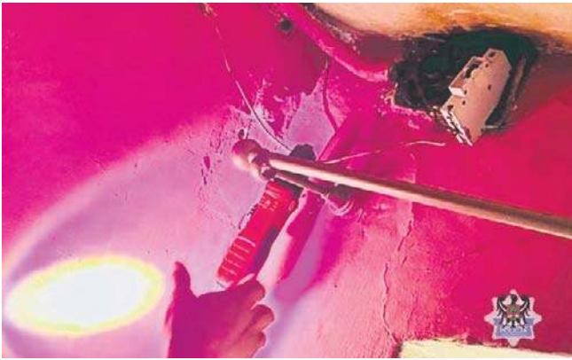
Zlikwidowano nielegalne przyłącze w Zagórzcu Śląskim. Kradzież energii elektrycznej jest przestępstwem.
