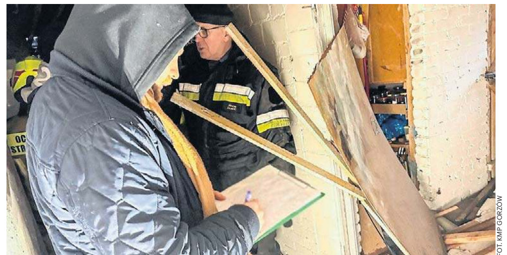
Po wybuchu w piwnicy trzeba było ewakuować 48 osób - mieszkańców budynku
