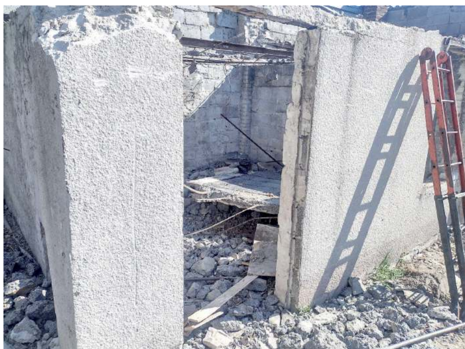
Pod zawalonym fragmentem stropu znalazło się dwóch starszych mężczyzn
