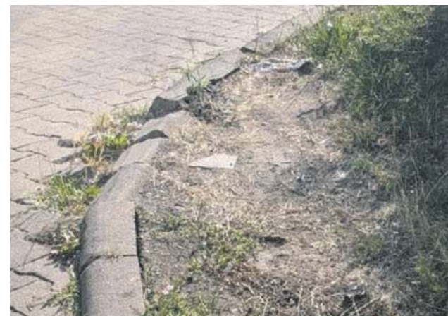
Efekt? Uszkodzone krawężniki, niszczone zieleń
