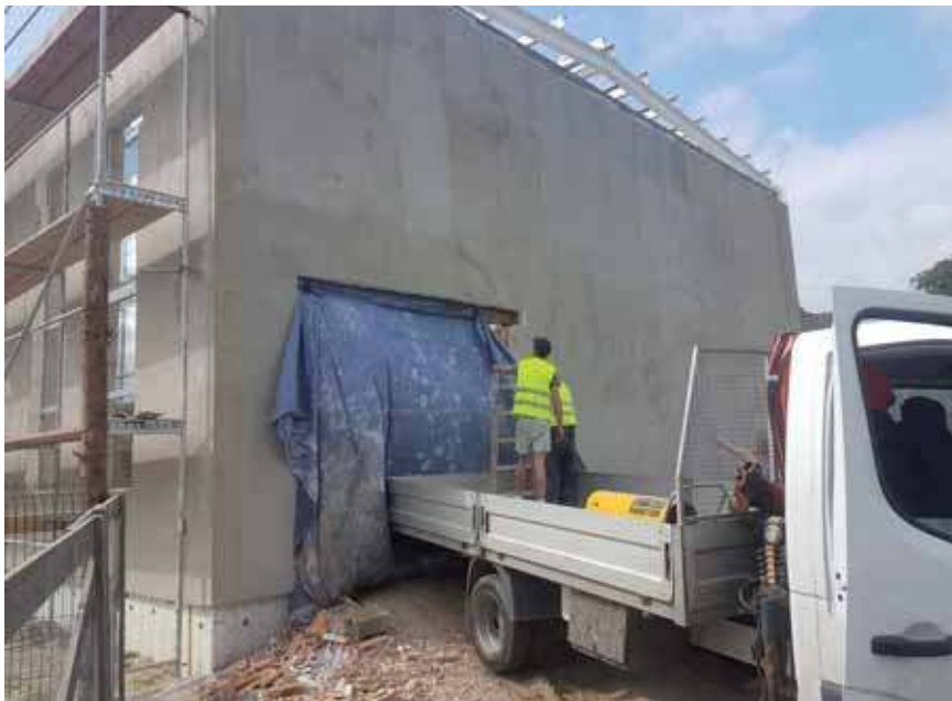
Druga ekspertyza, którą zlecieli na własny koszt zaniepokojeni mieszkańcy, pokazała, że ściany szczytowe grożą zawaleniem
