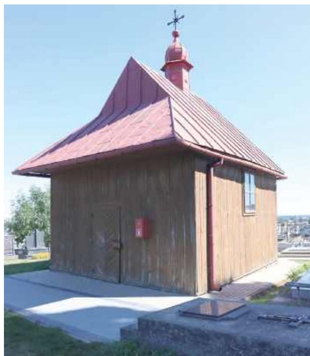
A tak kaplica wyglądała jeszcze niedawno
