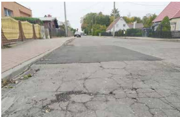
Częściowy remont wykonany został w poprzednim tygodniu, jednak już teraz widać, że kolejne poniszczone fragmenty powinny też być naprawione
