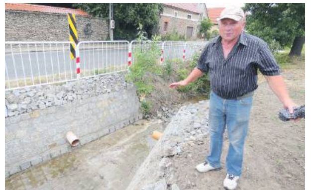
Pan Adam wskazuje na źle wykonany mur oporowy, który strumień wody będzie kierował na skarpę drogi. Na końcu lewego muru widać małe drzewko, którego tu nie powinno być
