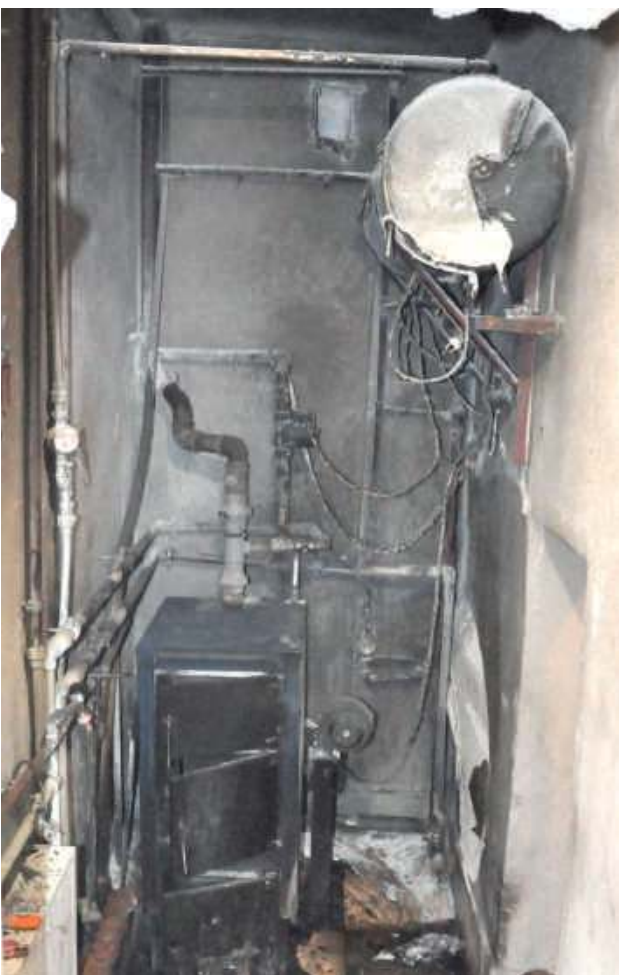
Pożar poważnie zniszczył kotłownię
