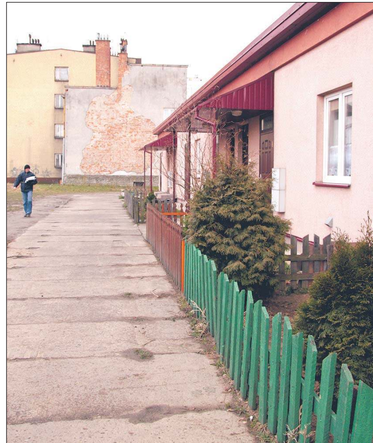
Lokatorzy budynków socjalnych na Mościckiego boją się o życie i zdrowie.
