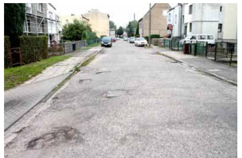
Ta droga i chodniki mogłyby wyglądać bardziej reprezentatywnie. Teraz zapewne zostaną tutaj przeprowadzone prace częściowe, by wyrównać nieco nawierzchnię.
