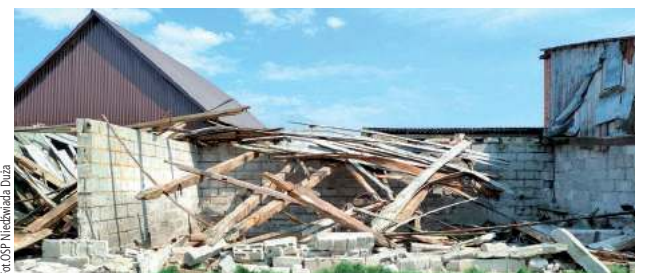
Zawaleniu uległ murowany budynek gospodarczy przykryty deskami
