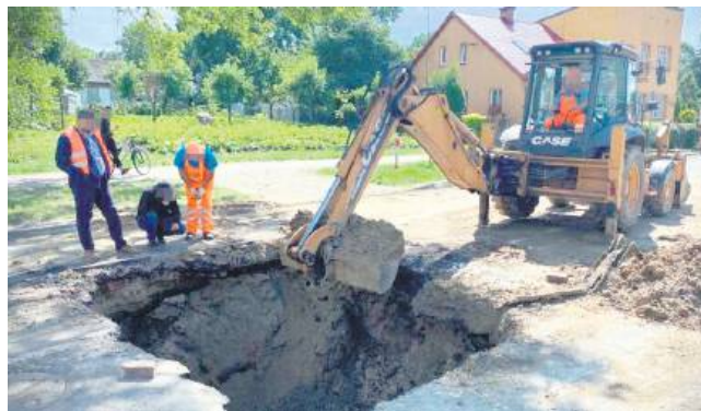
Drogowcy rozkopali zapadlisko, ale nie stwierdzili, co doprowadziło do osunięcia się ziemi pod jezdnią.
