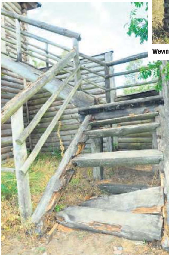
Schody na wieżę. To wszystko trzeba będzie doprowadzić do porządku i odbudować.
