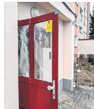
Pęknięte szybyw drzwiach wejściowych
