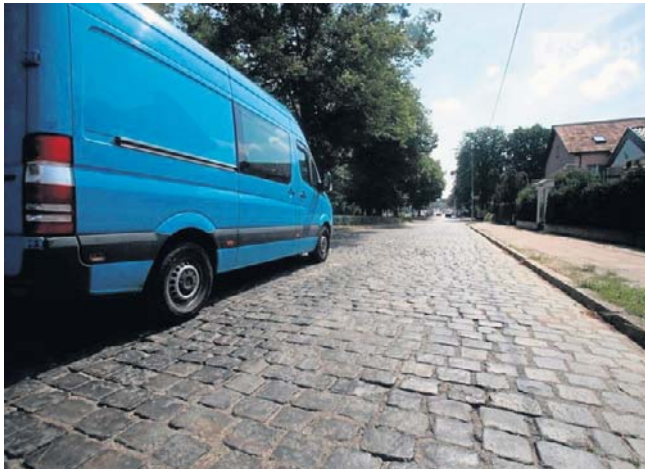
Przejazd ulicą Żołnierską nie należy do komfortowych. Kostka brukowa jest krzywa. Cierpią kierowcy i auta
