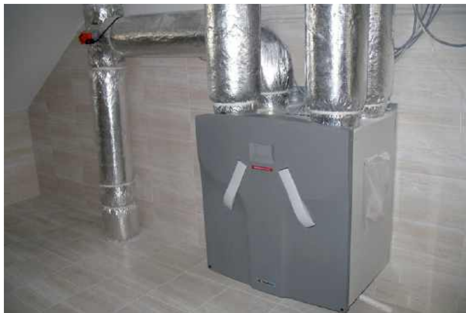
🔗 Izolacją, najczęściej z wełny mineralnej, otula się wszystkie kanały wentylacyjne. REKUPERATORY.PL
