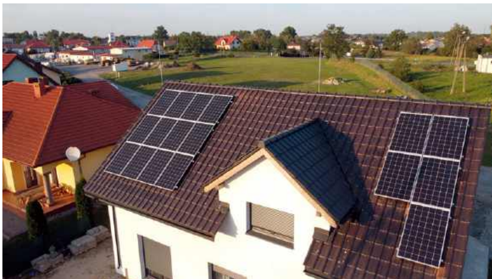
❗ Moc typowej instalacji fotowoltaicznej to 5–6 kWp. Większa sprawdzi się wtedy, gdy mamy w domu urządzenia zużywające dużo energii elektrycznej, np. pompę ciepła. HANPLAST ENERGY
