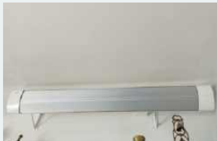
➤ Promienniki podczerwieni zawieszono wysoko na ścianie, na stalowym stelażu.
