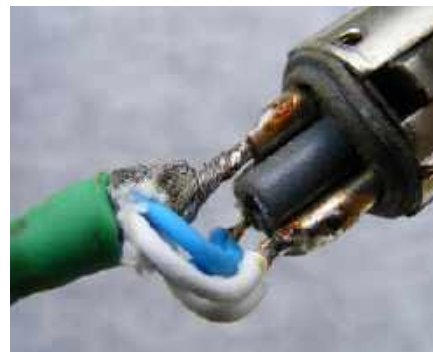
Rysunek 17. Prawidłowe zakończenie kabla Star Quad na XLR. Żyły tego samego koloru są połączone równoległe. Uwaga: niebieski jest przewodem „zimnym”
