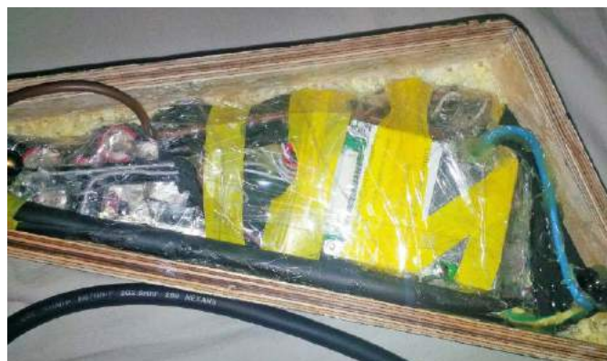
Fotografia 7. Akumulator umieszczony w obudowie
