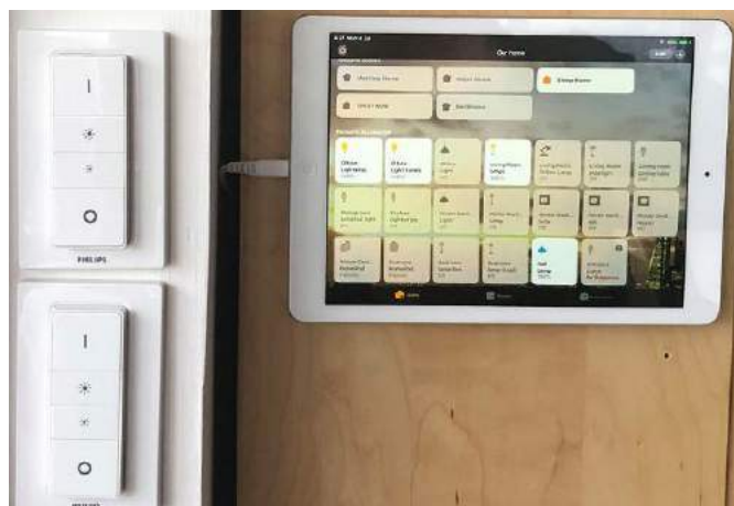
Fotografia 20. Rozbudowany panel sterujący
