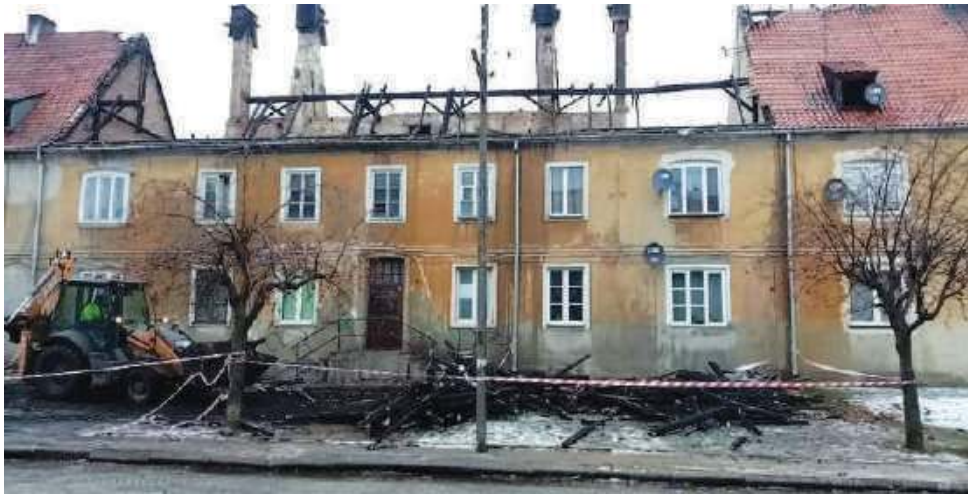
Budynek po pożarze
