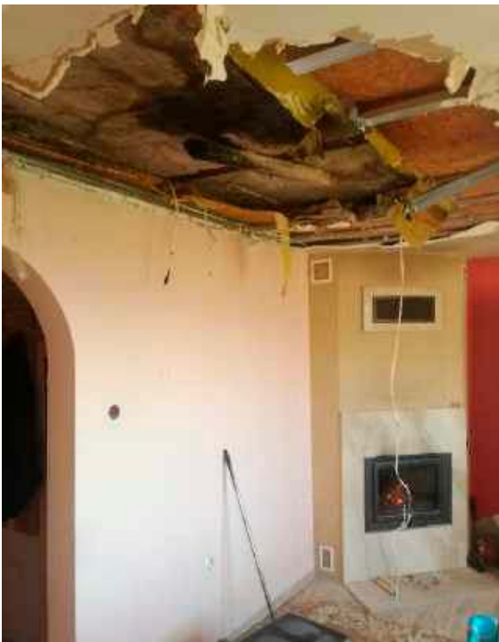
Ogień uszkodził sufit domu i do czasu remontu nie nadaje się on do zamieszkania
