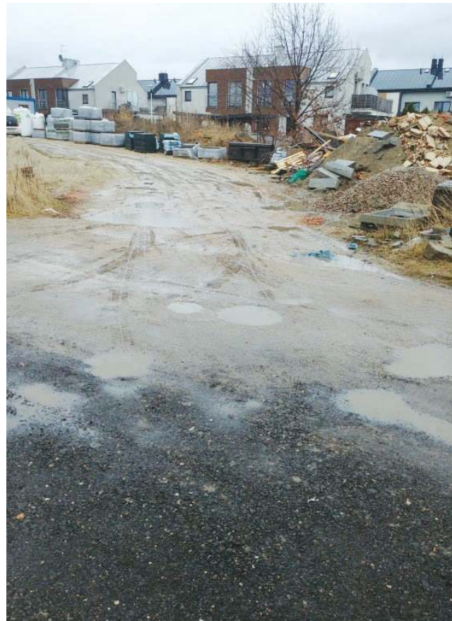
Błoto z budowy trafia na drogi publiczne
