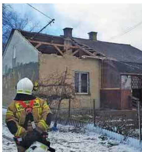
Wiatr zerwał część dachu z jednego z domów; z pomocą mieszkańcom przyszła OSP Świercze
