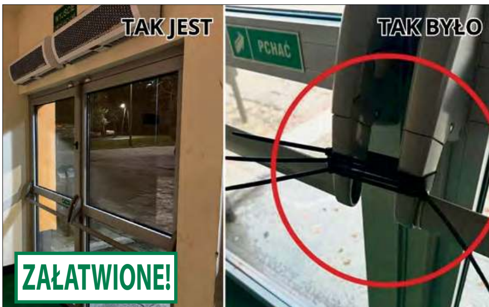
Po naszej interwencji usunięto trytytki zaciśnięte na klamkach drzwi Hali Widowiskowo-Sportowej w Krapkowicach.
