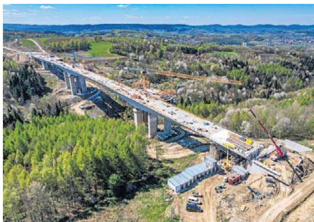
Na budowanym odcinku S19 Babica-Jawornik termin oddania przesunięto z obecnego roku na 2027.
