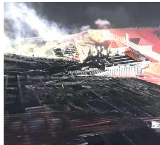
Ogień bardzo szybko opłamywał budynek. Zdjęcia: Zespół prasowy KP PSP w Łukowie
