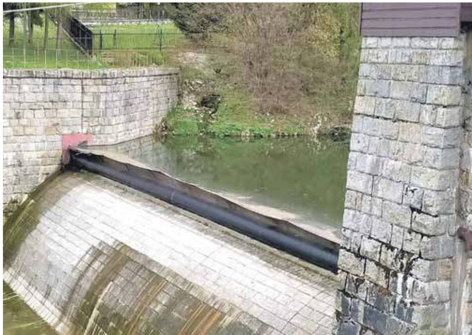
Większość ścieków, która pojawiła się na jazu w Szaflarach, już spłynęła niżej. Problem jednak pozostał.
